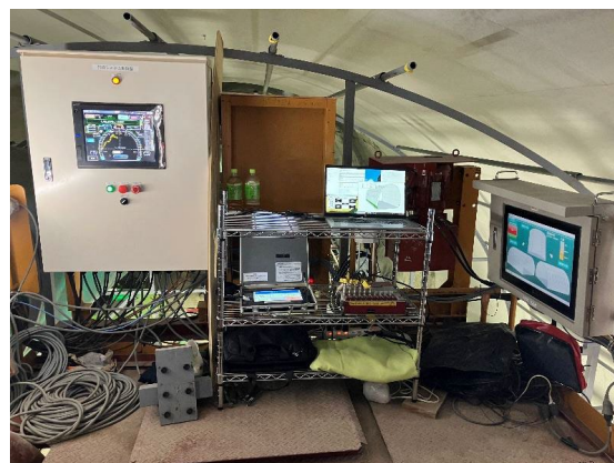
セントル上部の各種制御盤
