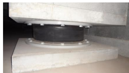
【免震システム】
