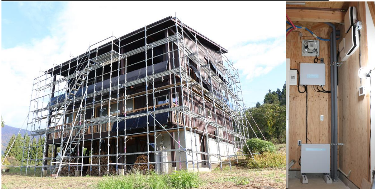
左：南から全景、右：デルタ電子・SAVeR-H ハイブリッドシステム（宅内）
