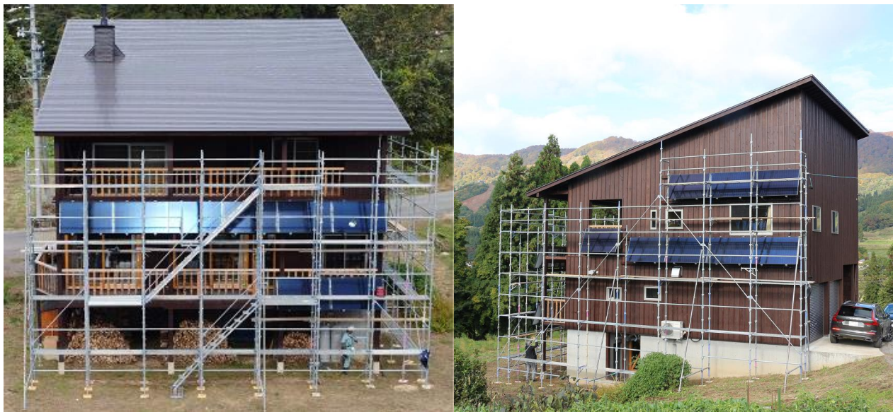
左：南西面 右：東南面 独立 MPPT 回路により、南西面、東南面の太陽電池アレイを発電コントロール
