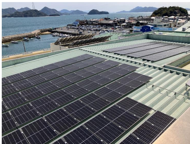
ジャム工場に設置した太陽光発電設備
