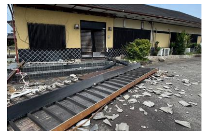
桜屋 震災後の様子
