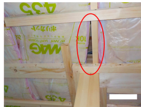
不具合事例：断熱材の隙間
