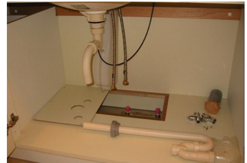
配管の未施工実例
