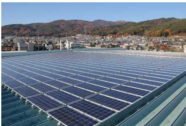
長野岡谷工場に導入された太陽光発電システム
