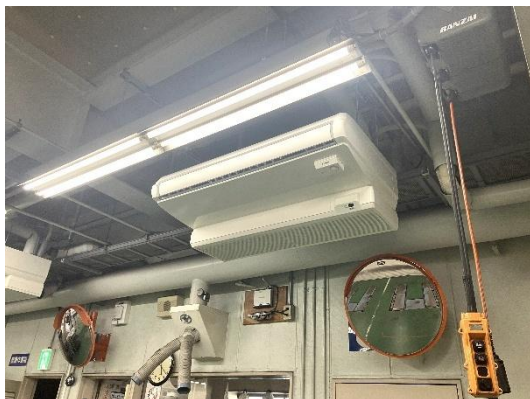
馬小屋タイプの整備工場のエアコン設置事例
