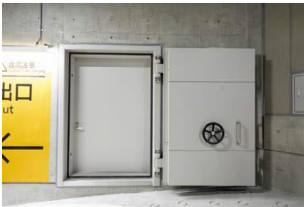
水密扉（地下機械室）
