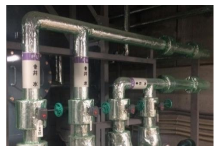
緊急時のみ稼働する井戸水からの給水
