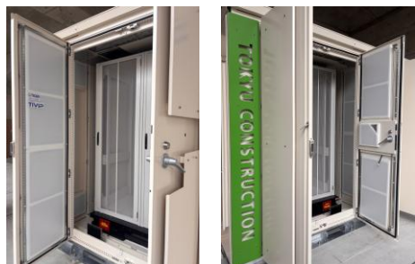
コールドアイル（冷却通路）部分の側面や上面をTIVIPで断熱
