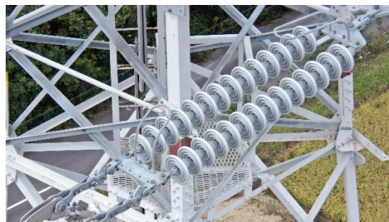
大型設備がいし
