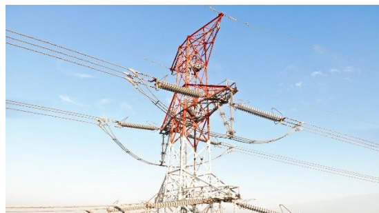
大型送電設備
