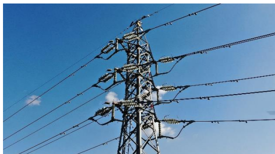
標準的な送電設備
