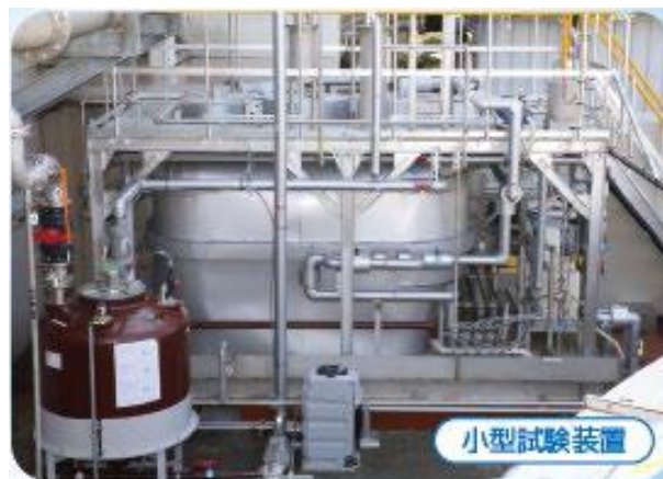
▲下水処理場内小型試験装置
