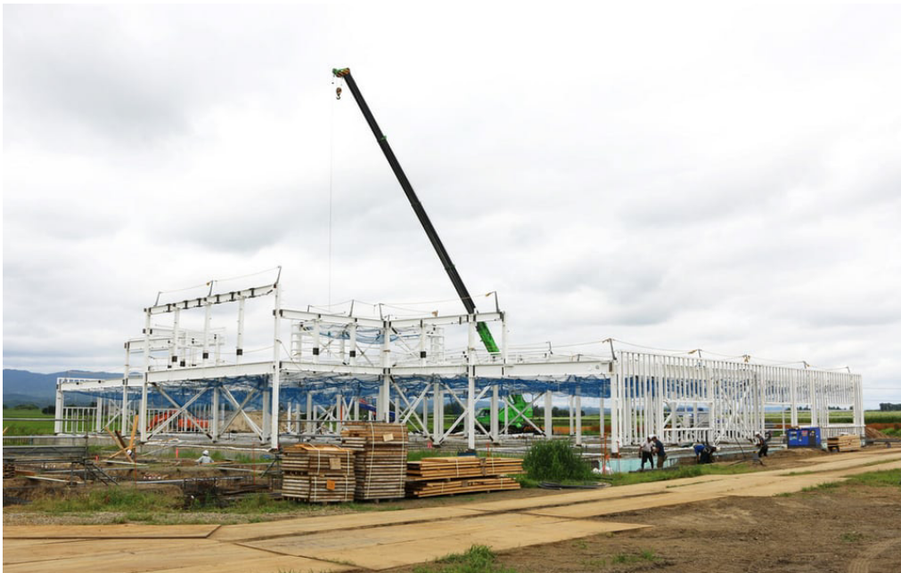
2022年7月末時点 「みんなの工場」建設予定地(江陽小学校跡地)の様子
