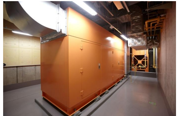
非常用発電機
