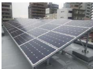
太陽光発電設備+蓄電池
