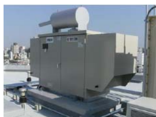
非常用発電機
