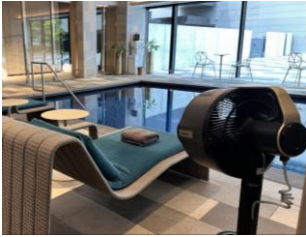
施設名：富士スピードウェイホテル 導入箇所：プールサイド
