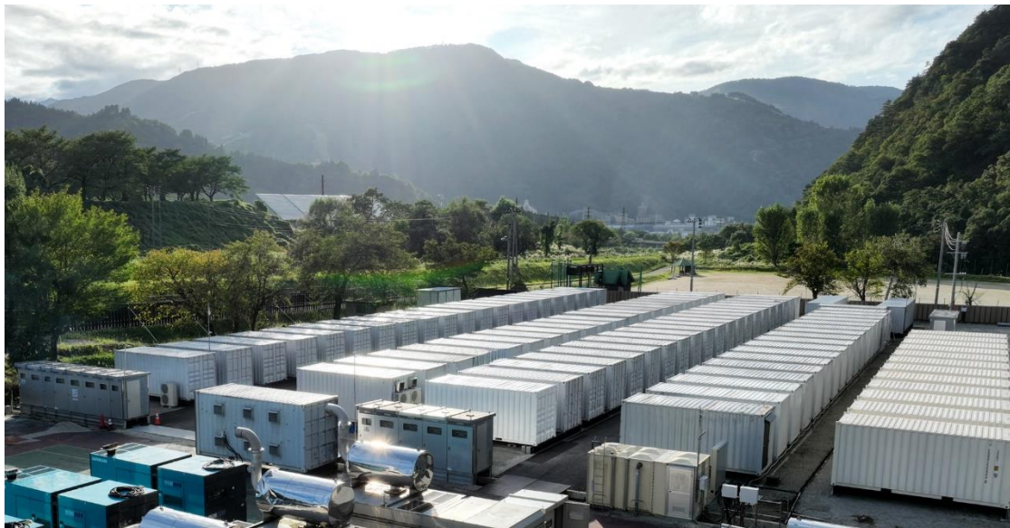
液冷サーバーシステムを提供したコンテナ型データセンター「湯沢 GX データセンター」
