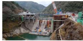
改造工事中 (H34.5末運開予定) H30.5~12にラジアルゲートで日本 最大のゲート面積の洪水吐ゲートを設置
