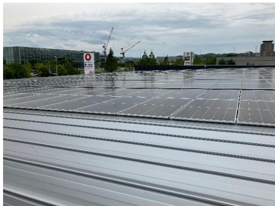
▲屋上に設置した太陽光パネル
