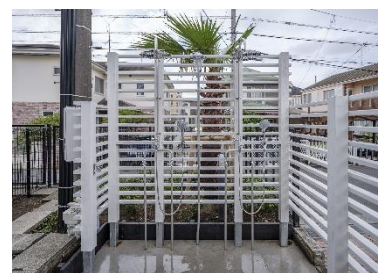
屋外シャワー兼ペット足洗い場 （撮影：千葉正人）
