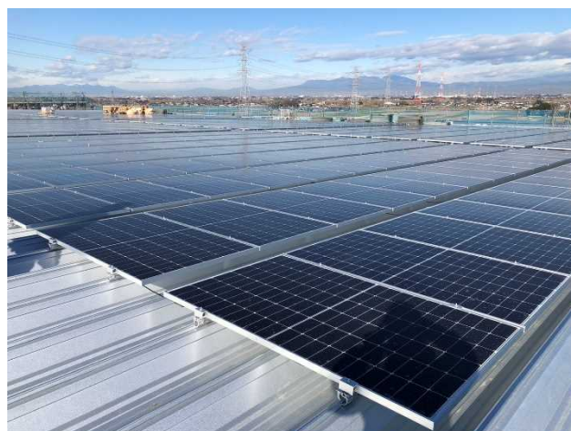
太陽光パネル
