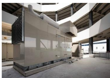
非常用発電機
