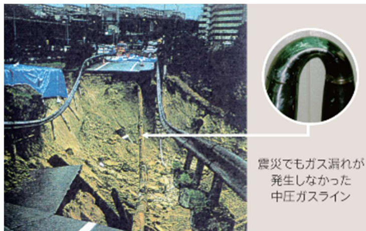
震災でもガス漏れが発生しなかった中圧ガスライン 出典:「ガス地震対策検討会報告書(1996 年)」(資源エネルギー庁)
