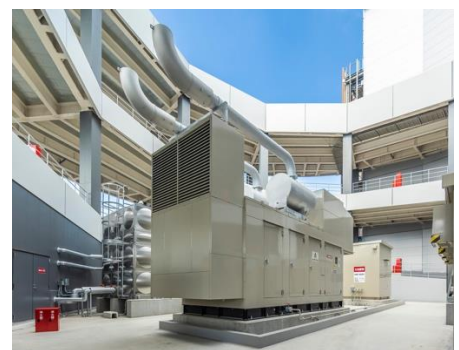
非常用発電機
