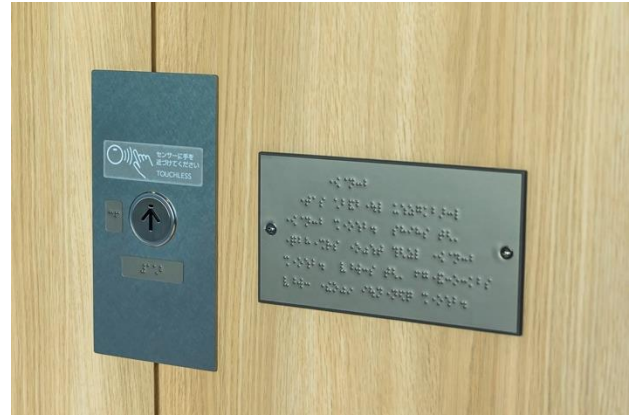
非接触型のエレベーターボタン
