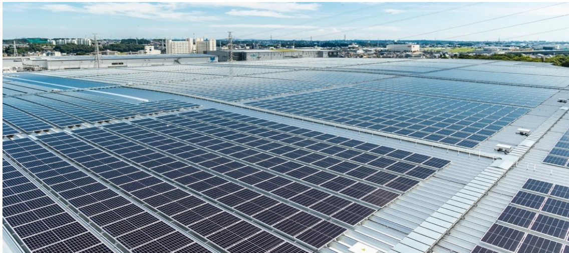
屋上に設置された太陽光パネル
