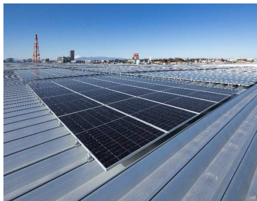
太陽光発電設備
