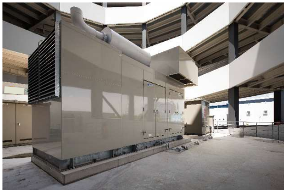
非常用発電機イメージ
