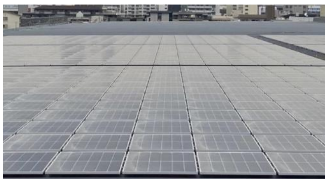
屋上「空の広場」からの太陽光パネルの様子
