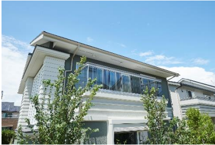
【本モデルハウスバルコニーに設置のペロブスカイト太陽電池写真】
