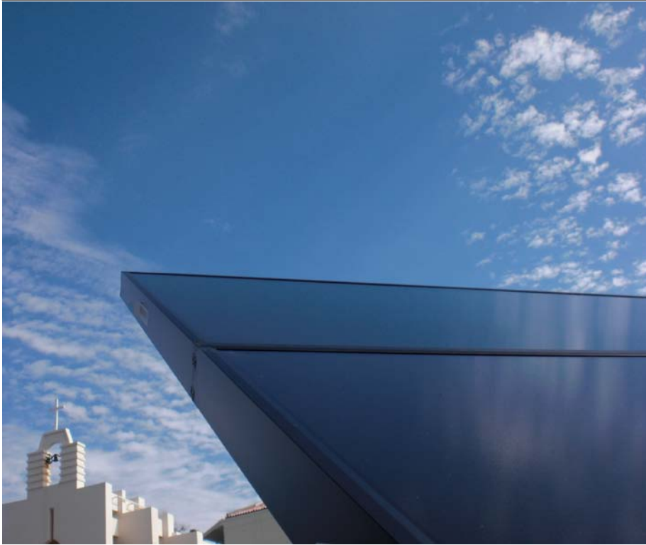
写真① 太陽光発電パネルの外観
