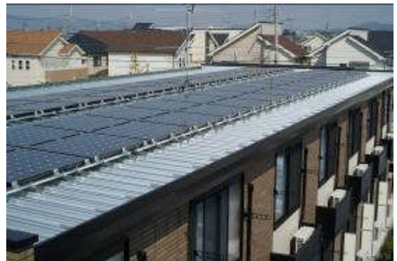
アパートの屋根に設置された太陽光パネル
