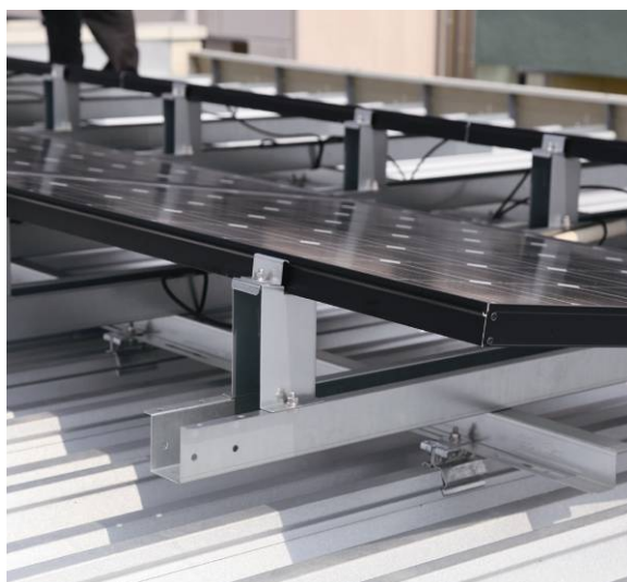
「太陽光発電システム」の設置部
