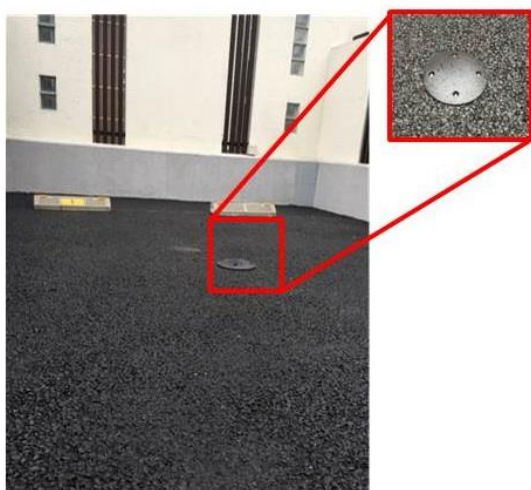
地磁気センサー(駐車場)
