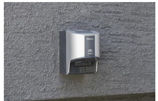
EVコンセント
