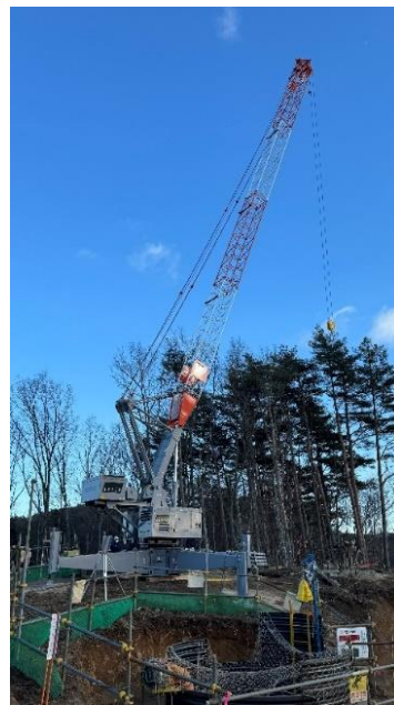
ジブクレーン
