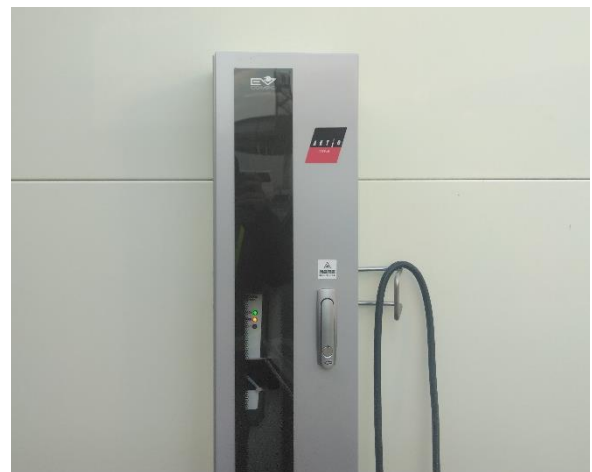
【EV 充電スタンド】
