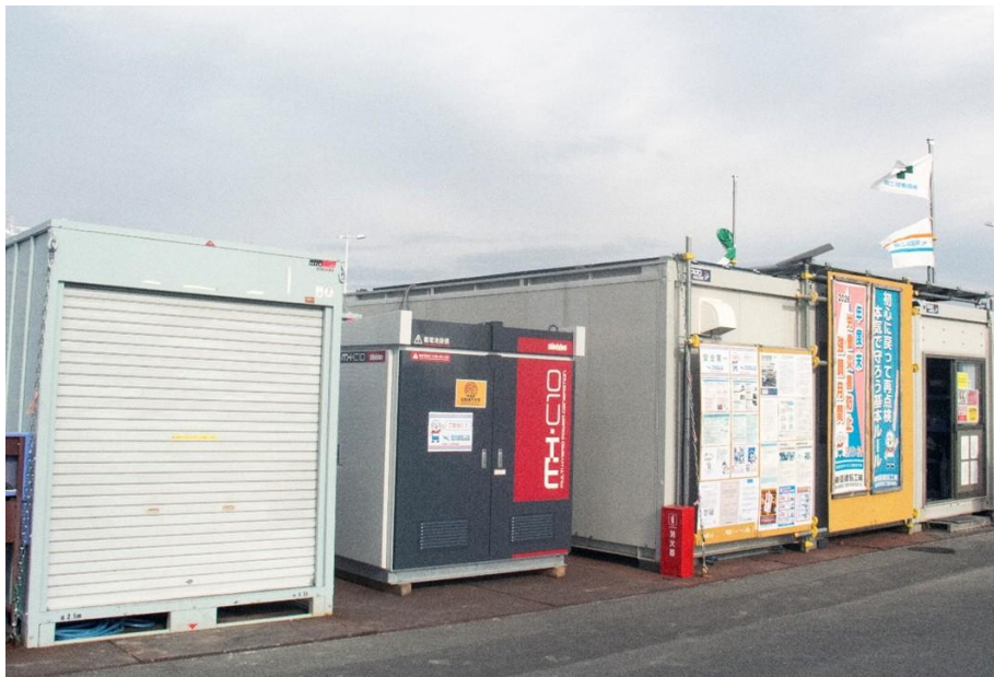
工事現場仮設事務所に設置されたマルチハイブリッドシステム
