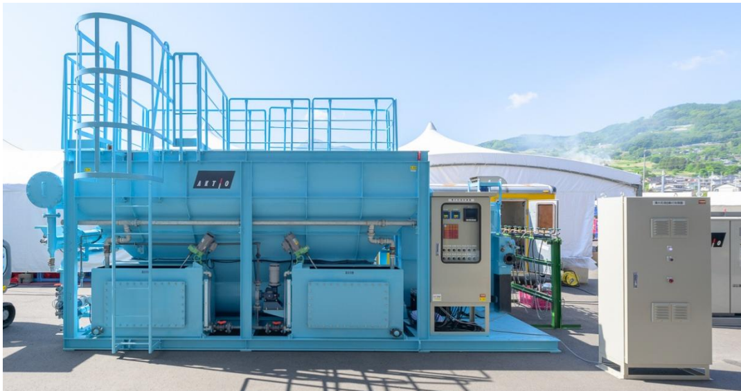
【薬品自動注入装置 30m 3 /hタイプ】
