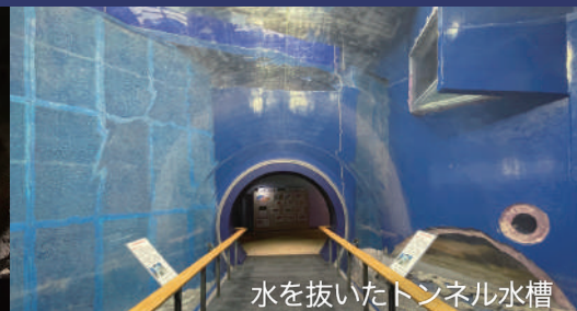
水槽の大規模な破損
