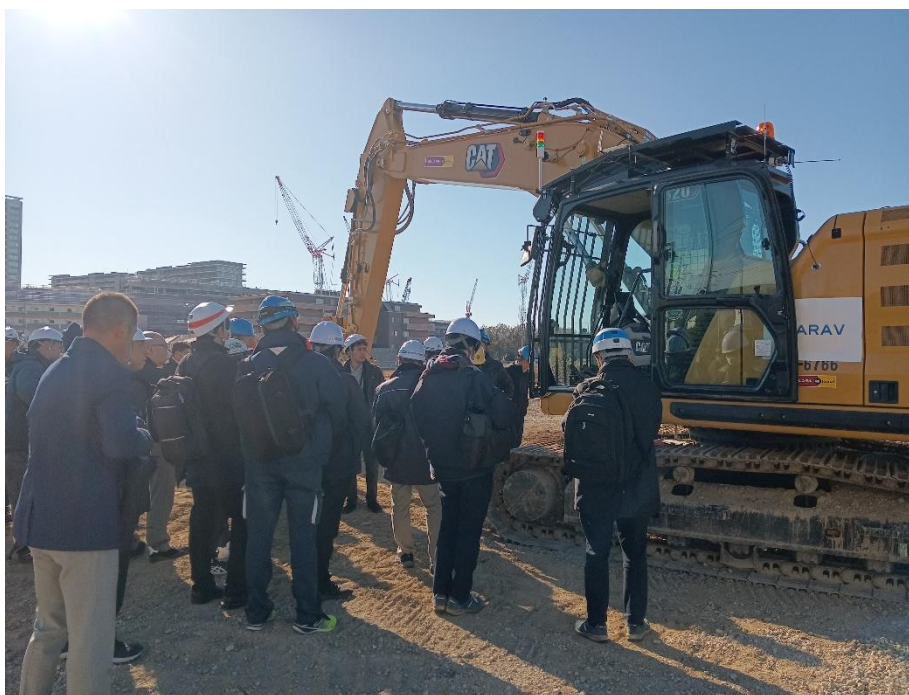
国土交通省 現場検証の様子
