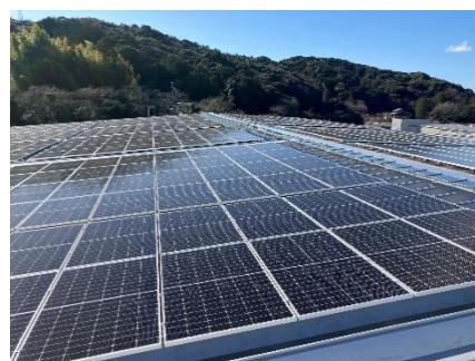
遠州工場の太陽光パネル
