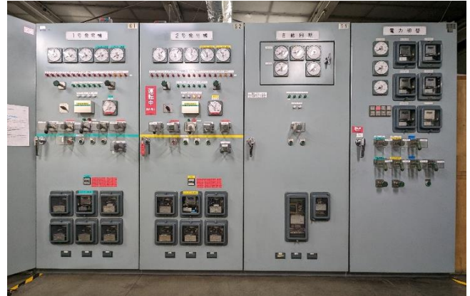
昭和基地内に設置された発電機制御盤
