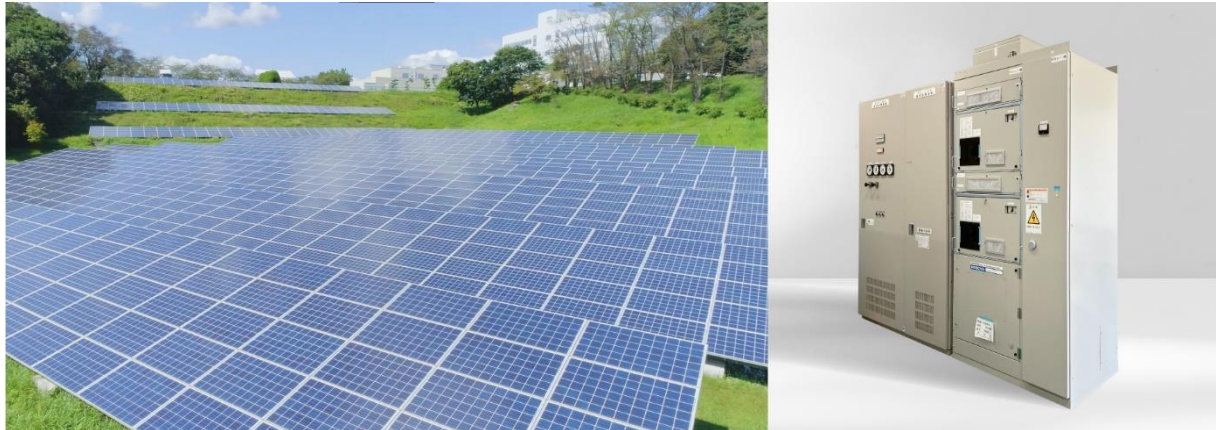
日立の大みか事業所における実証に用いられている、太陽光発電機(左)と BTB(右)
