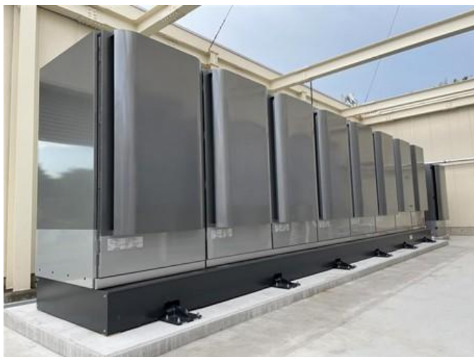
日立大みか事業所で実証試験中の燃料電池システム
