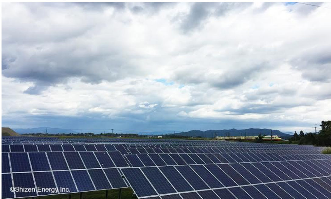
*胎内自然電力太陽光発電所・胎内自然電力第二太陽光発電所*
