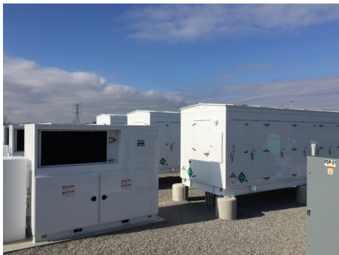
蓄電コンテナ外観
