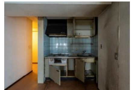
老朽化したキッチン設備
