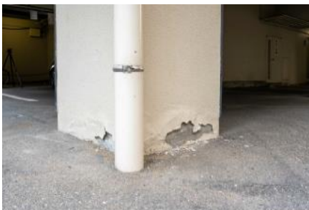
劣化した外装
