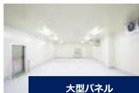
大型パネル 冷蔵設備
