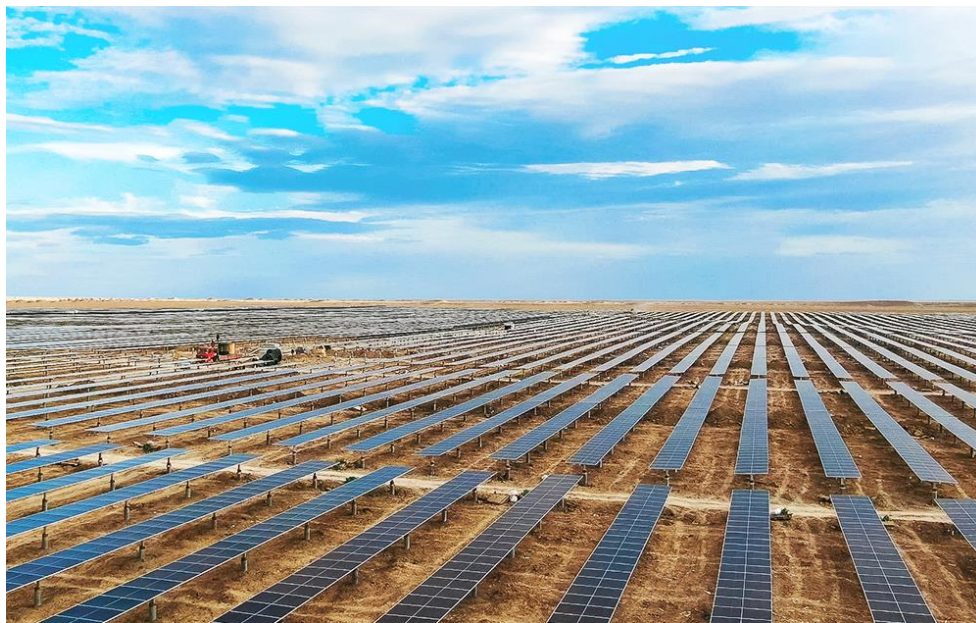
青海省ターツアイダム 112MW 太陽光発電所
