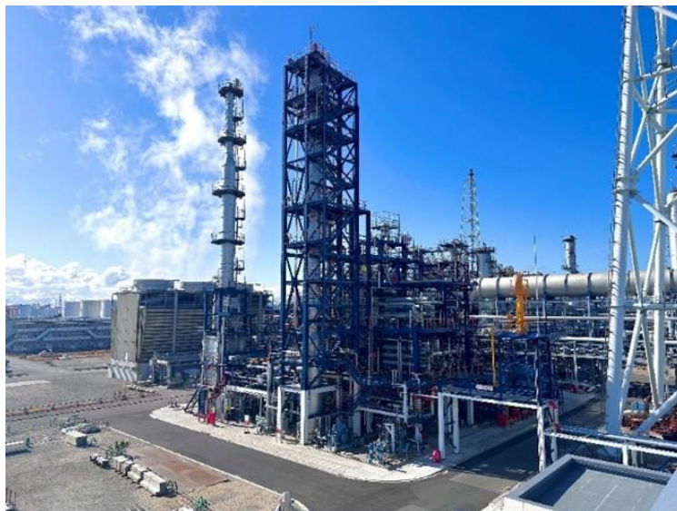
SAF 製造装置（コスモ石油堺製油所内）
